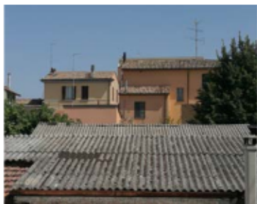
Coperture di amianto
